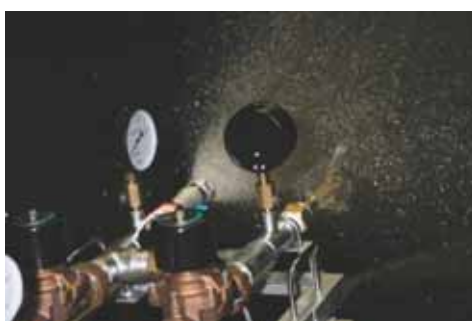
噴霧放水状態
